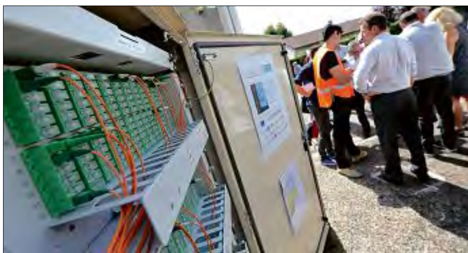
Les armoires de raccordement permettent d'alimenter des quartiers entiers en fibre.
